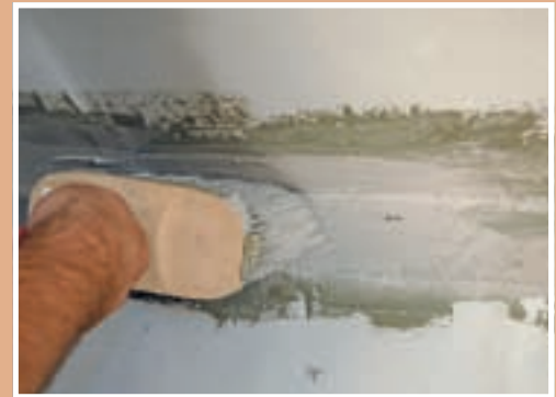
2. Aplicarea primului strat de pastă hidroizolantă se realizează cu bidineaua sau pensula.
