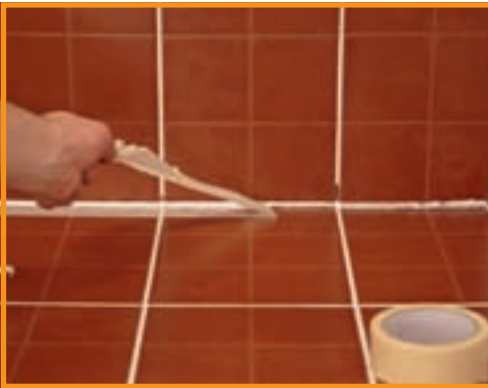
19. Benzile de protecție se desprind și... am obținut o zonă impermeabilă, cu proprietăți hidroizolante.
