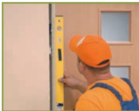
5. Este momentul când trebuie verificată poziția corectă a ușii, eventual modificată poziția penelor.
