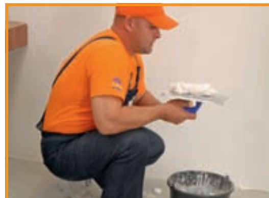
13. Lucrarea a continuat cu aplicarea unui sistem de două gleturi, unul pentru denivelări de până la 10 mm...
