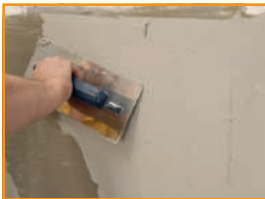
6. Un al doilea strat de hidroizolație, bine nivelat, a pregătit suprafața pentru placarea cu gresie și faianță.
