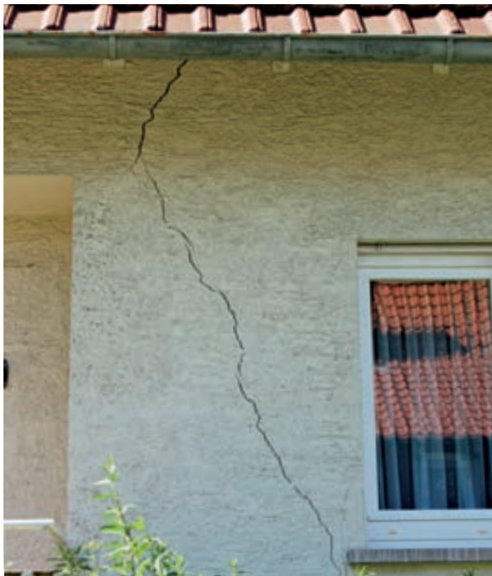
La baza deteriorărilor casei s-a identificat evaporarea apei din sol, determinând uscarea lui pronunțată pe o suprafață extinsă și la mare adâncime, din cauza rădăcinilor copacilor ce se întindeau mult sub clădire.
