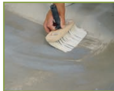
3. Și pardoseala trebuie amorsată. Altfel, betonul va absorbi prea repede apa din adezivul pentru gresie.
