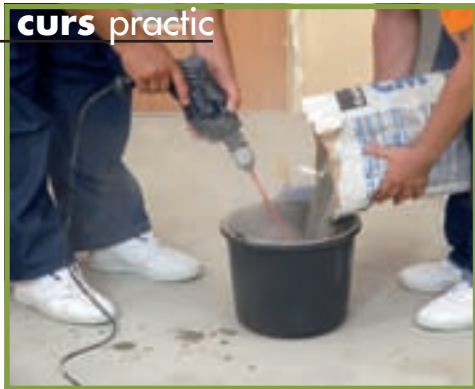
7. Prepararea adezivului se face mecanic, în mai multe reprize, pentru a elimina bulele de aer.
