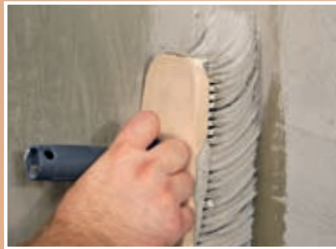
5. Acest produs este recomandat și pentru acoperirea eventualelor fisuri din stratul suport.
