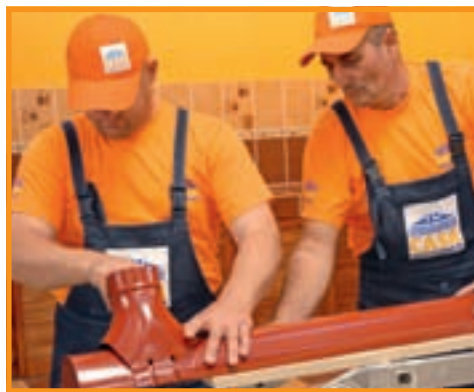
27. La montarea racordurilor, se evită deteriorarea straturilor de protecție prin îndoire sau lovire.
