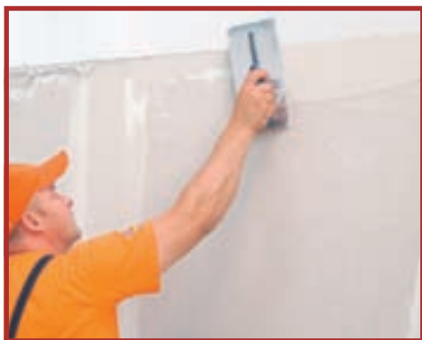
10. Acoperirea cu glet va reduce denivelările suprafeței, luând ca reper linia colțului superior.
