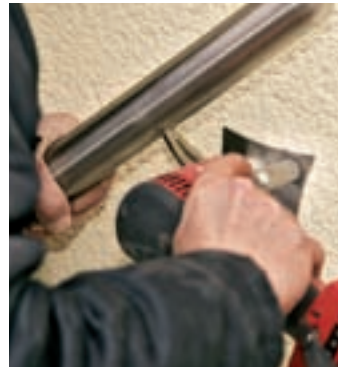
21. De peretele casei este fixată o țevă din oțel superior, ca mână curentă suplimentară. Și aici...
