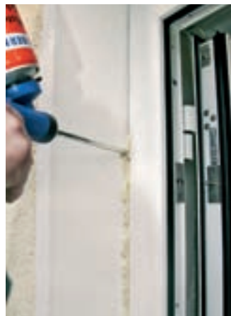
18. În final, rosturile dintre cadrul și zidărie trebuie umplute cu spumă de montaj. Anterior acestei operațiuni, ramele trebuie protejate cu bandă de hârtie pentru a nu se murdări.
