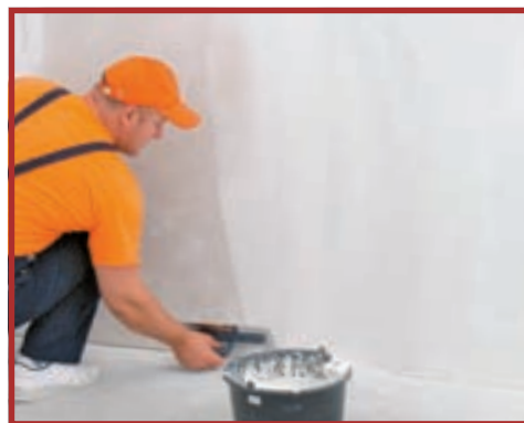
12. Când gletul se va întări, se poate aplica un nou strat de pastă pentru umplere și nivelare.
