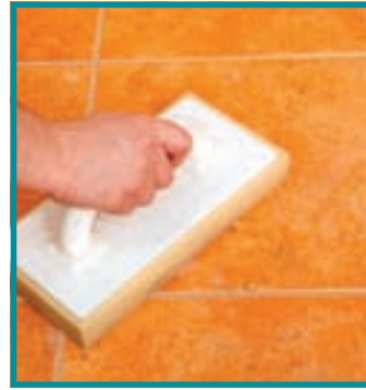
16. Excesul de chit întărit a fost îndepărtat cu o racletă iar murdăria cu o gletieră cu burete umezit.
