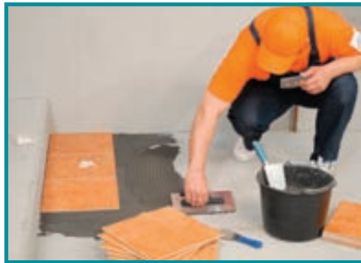
12. Pentru pardoseală, se va utiliza o gresie potrivită cu nivelul de trafic estimat pentru această sală.
