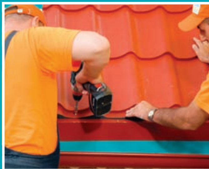
12. Montarea țiglelor începe de la streășină spre coamă. Țiglele de la bază se fixează în partea de jos folosind șuruburi cu șaiță de cauciuc.
