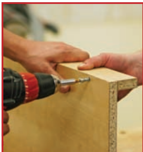
10 Rând pe rând, sunt realizate toate rafturile. Nu insistați la înșurubare, deoarece PAL-ul este un material sensibil!
