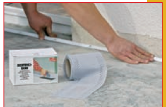
6. Trebuie determinate lungimile benzilor izolatoare destinate zonelor de contact dintre perete și pardoseală (tencuiala fiind degajată pe o fâșie lată).
