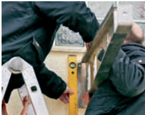
23. Elementele portante ale copertinei sunt amplasate temporar la înălțimea dorită, timp în care se trasează punctele de găurire.
