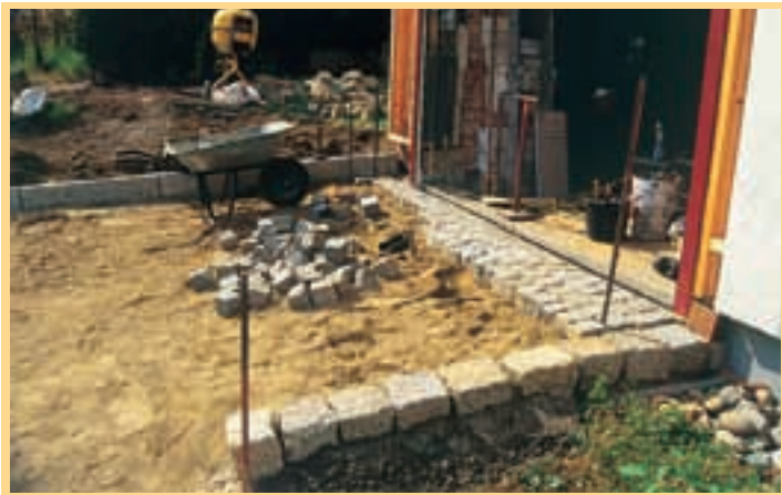
6. Aplicarea pietrelor de pavaj începe de la ușa garajului. În timpul acestei operațiuni trebuie luată în calcul înclinația naturală a terenului.
