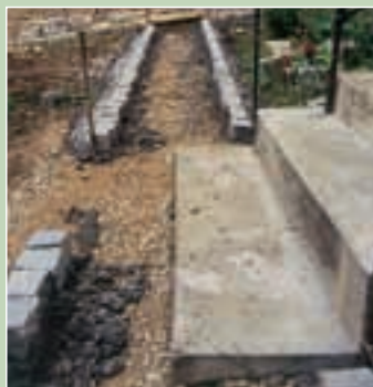
1. Bordurile aleilor au fost așezate la o cotă mai înaltă decât cea a ultimei trepte, prestabilindu-se înălțimea...
