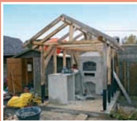
10. Respectând prevederile împotriva incendiilor, în jurul cuptorului a fost executată o construcție semideschisă, cu rol de protecție la intemperii.
