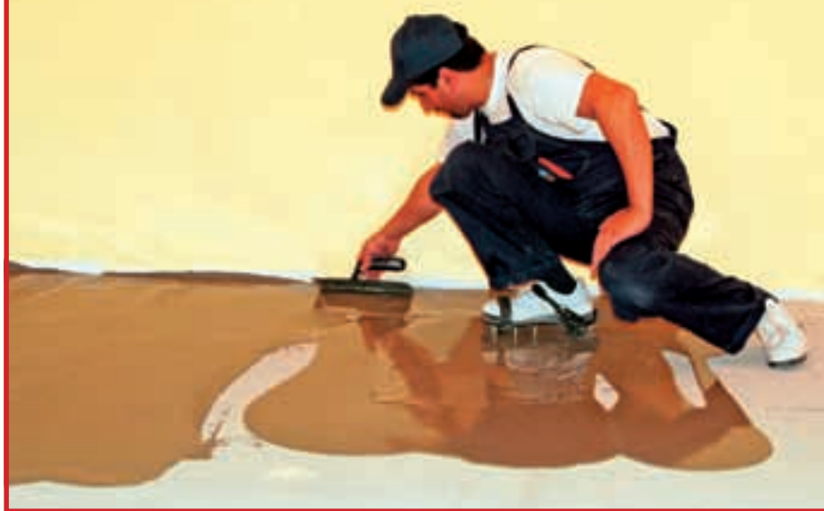
2. Turnată cu o găleată, șapa se va întinde cu ajutorul unei gletiere. Pentru a evita să vă murdăriți, puteți utiliza accesorii speciale, ca cele din imagine.
