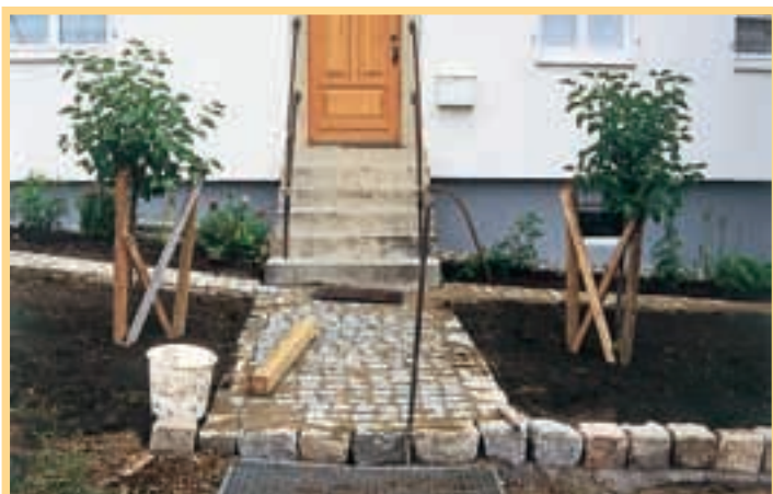
14. Drumul care trece prin grădină și face legătura între casă și stradă este deja finalizat, la fel ca și ambele ramificații.
