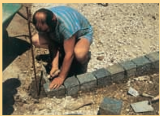
4. Pe latura dinspre grădină, bordurile au fost executate cu pietre de format mai mare, aplicate în pat de mortar.
