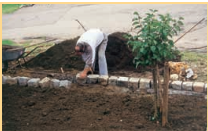
15. Pentru a încheia cât mai ordonat lucrarea, specialiștii așază acum un rând de piatră cubică și de-a lungul liniei perimetrice dintre proprietate și stradă.
