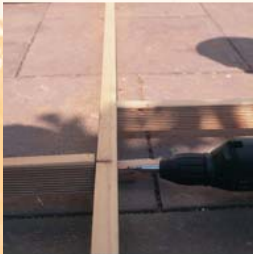
1. Structura suport din lemn pentru noua pardoseală a terasei a fost așezată direct pe vechile plăci din beton. Pantă recomandată este de 1%.
